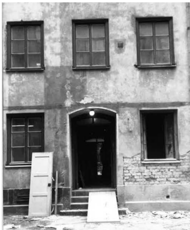
Fasaden före renovering. Ingång till museet kommer att kunna ske såväl från gården som genom nyupptagna dörröppning från biblioteket Wallingatan 26A.
